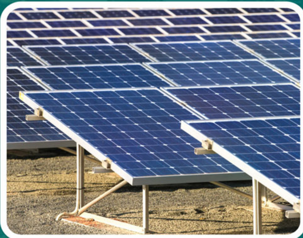
山东日照五莲县宁旭新能源200MW平价光伏项目
